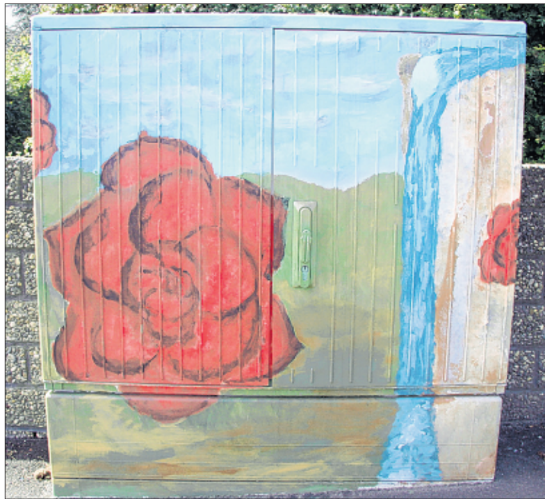
Auch aus dem Stromverteilerkasten in der Straße Am Taubenbaum ist ein kleines Kunstwerk geworden. (Foto: Statt-Rühl)
